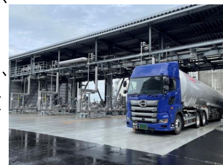
タンクローリー向け出荷設備
