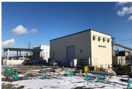
水素製造装置建屋 外観
