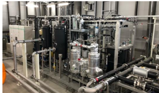
水素製造装置
