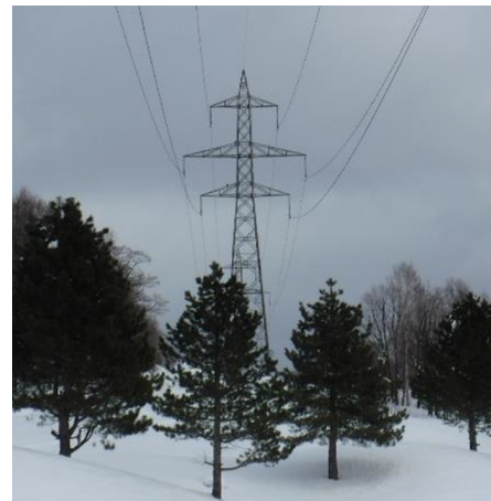
山中に建つ鉄塔
