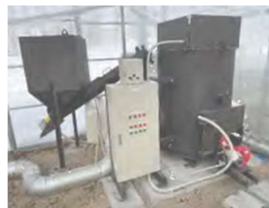
開発中バイオマスボイラ
