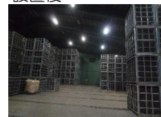
写真3 本照明装置設置前後の庫内状況
