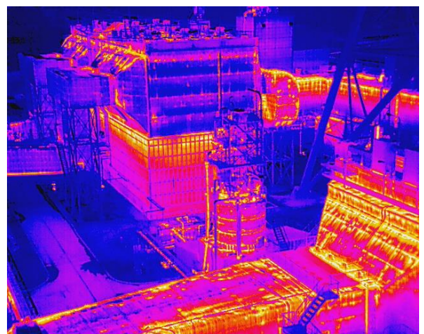
図—2 屋外点検用ドローンからのサーモ画像
