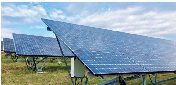
釧路益浦太陽光発電所
