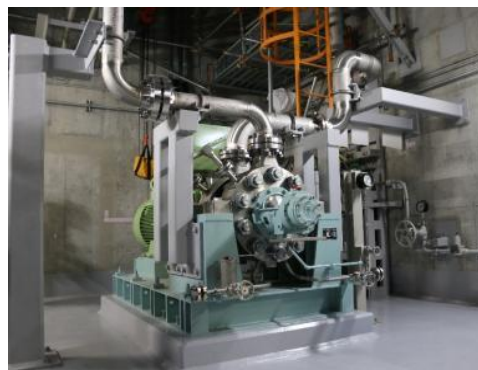
代替格納容器スプレイポンプ（常設）
