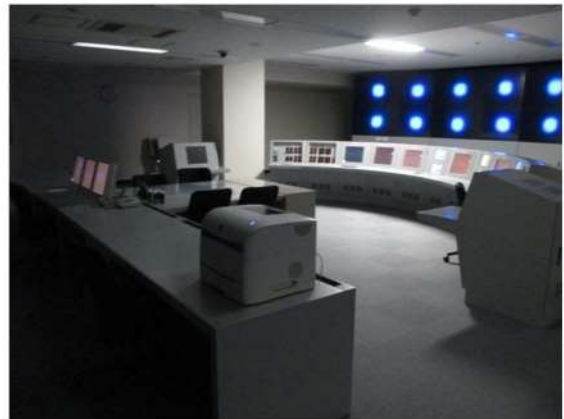
無停電運転保安灯点灯時
