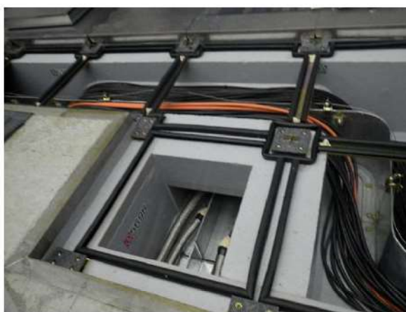
第 41-1-24 図：フロアケーブルダクトの状況
