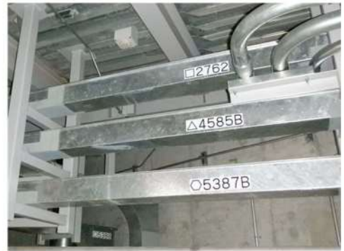
ケーブルトレイ，電線管の例
