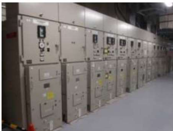
第 41-1-25 図：3A-安全補機開閉器室の状況
