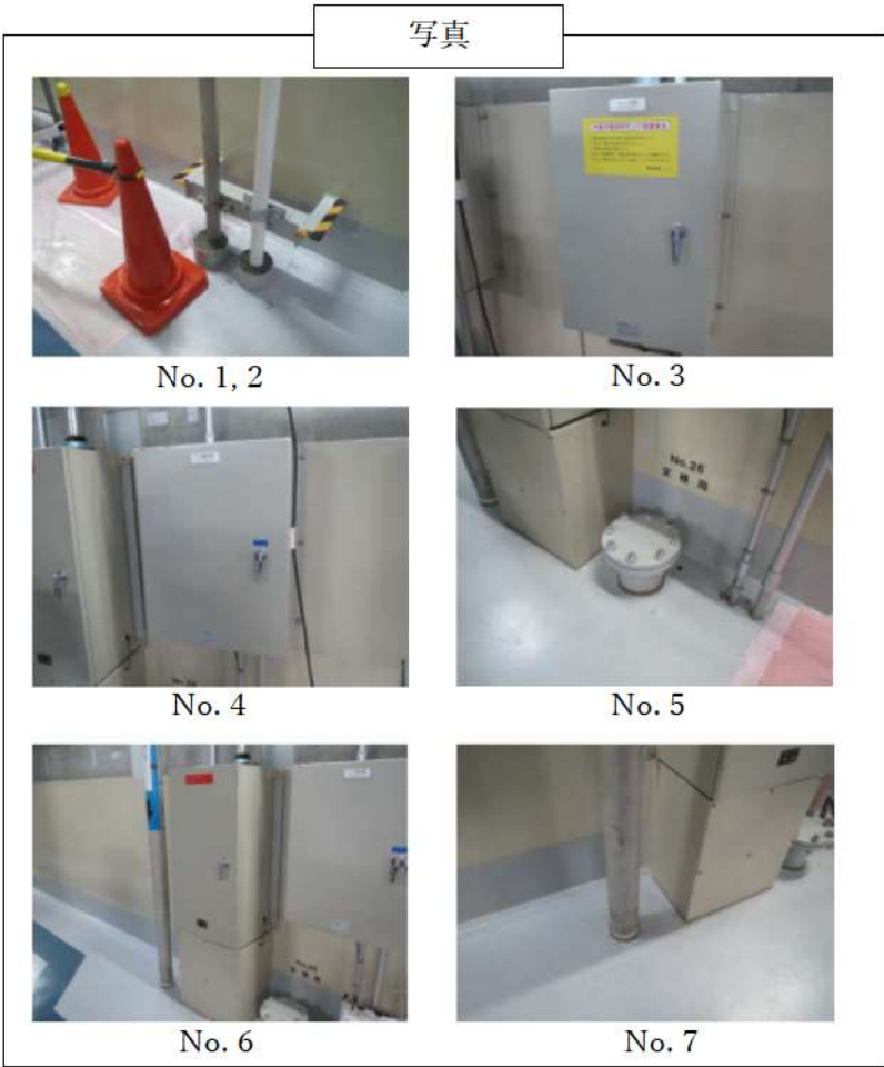
図2 床面積欠損対象物の測定結果例
