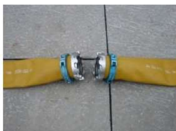
可搬型ホース(150A)接続前
