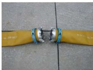
可搬型ホース (150 A) 接続前
