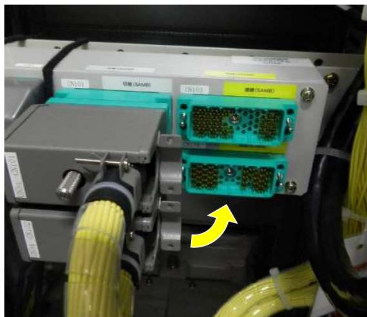
(1次系制御監視盤内 切替器)
