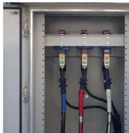
ボルト・ネジ接続 (代替交流電源)
