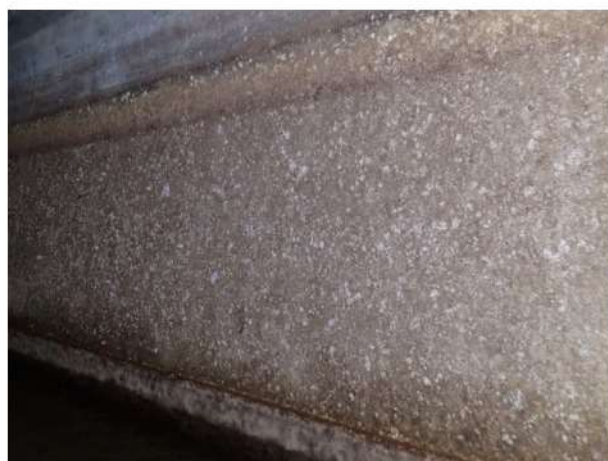
2023 年 2 月点検時の写真 (壁面拡大) 新たな貝の付着なし
