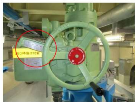
電動弁（手動操作レバー） (周辺補機棟 T.P. 17. 8m (中間床))
