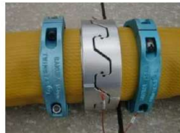
可搬型ホース(150A)接続後
