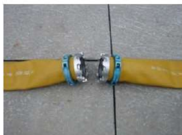
可搬型ホース（150A）接続前
