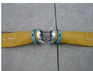
可搬型ホース(150A)接続前
