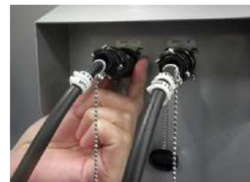
検出器用ケーブル接続
