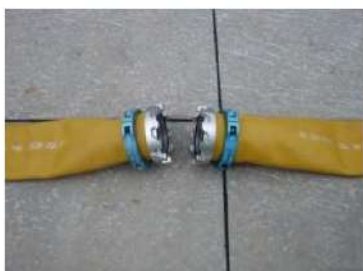
可搬型ホース(150A)接続前
