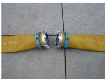
可搬型ホース(150A)接続前
