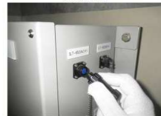
ケーブル接続 BOX
