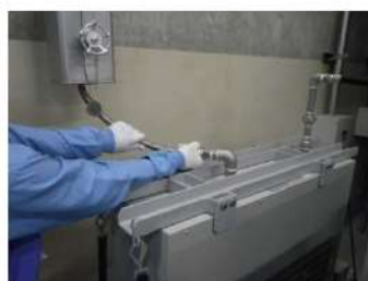
空冷配管との接続
