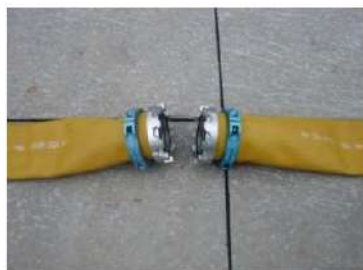
可搬型ホース(150A)接続前
