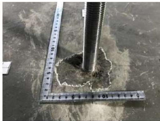
(ひび割れ箇所除去後)
