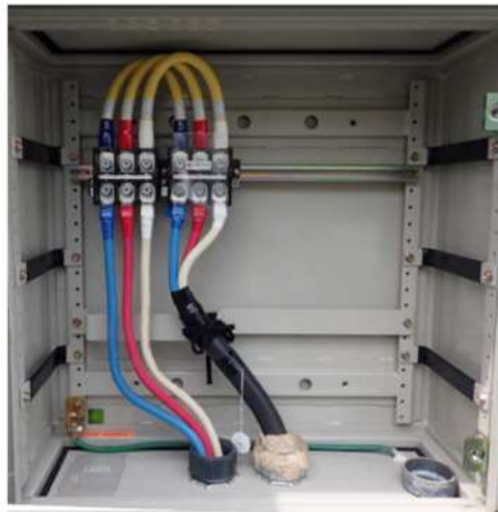
ボルト・ネジ接続 (代替直流電源)
