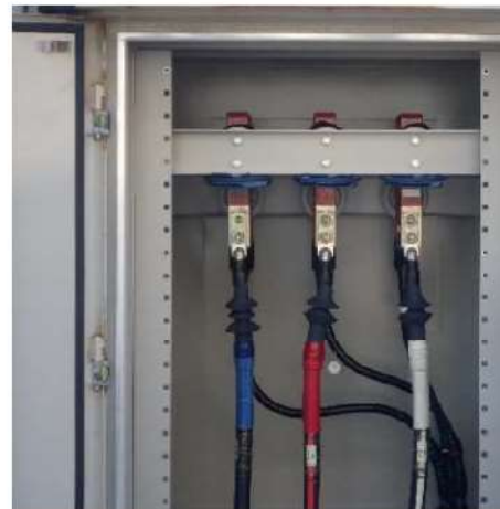
ボルト・ネジ接続 (代替交流電源)
