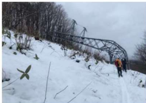
大雪による鉄塔倒壊事例 ※3
