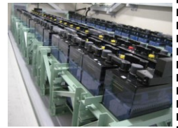
・蓄電池 ・後備蓄電池
