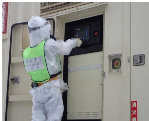
電源車起動訓練
