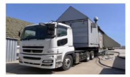
代替非常用発電機
