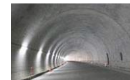
石炭灰を再利用したコンクリートによるトンネル覆工
