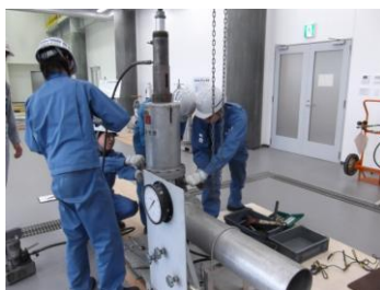
火力技術研修センターでの 安全弁分解組立研修
