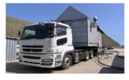
代替非常用発電機
