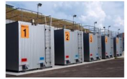
代替屋外給水タンク(T.P31mに設置)
