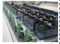
・蓄電池 ・後備蓄電池
