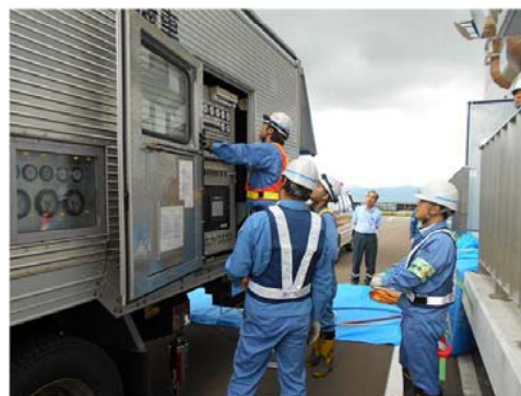
発電機車起動
