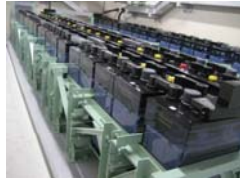
・蓄電池 ・後備蓄電池
