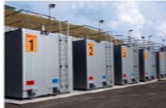
代替屋外給水タンク (T.P31mに設置)
