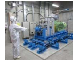
蒸気発生器直接給水用高圧ポンプ
