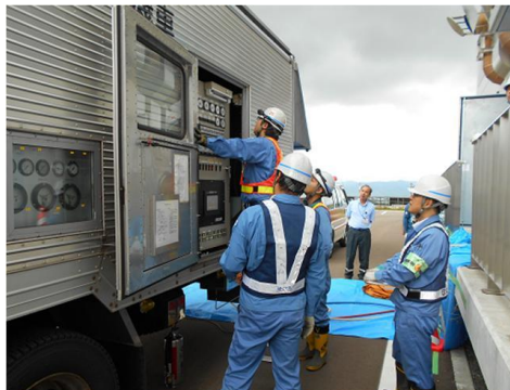
発電機車起動
