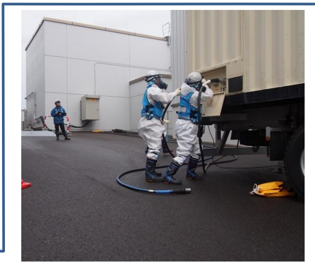
電源車つなぎこみ訓練
