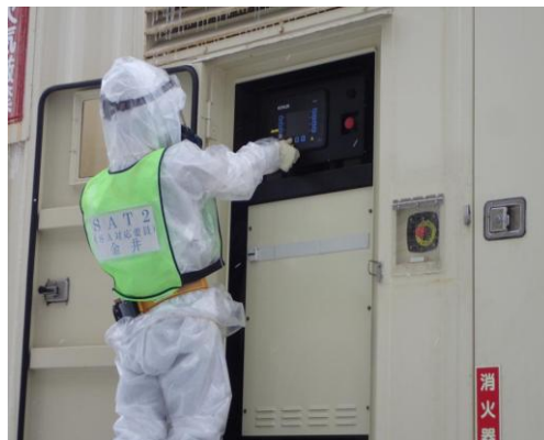
電源車起動訓練
