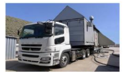
代替非常用発電機
