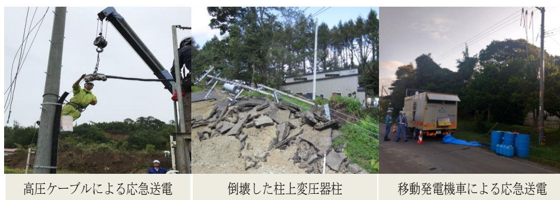
図 2.10 高圧ケーブルや移動発電機車による応急送電状況
