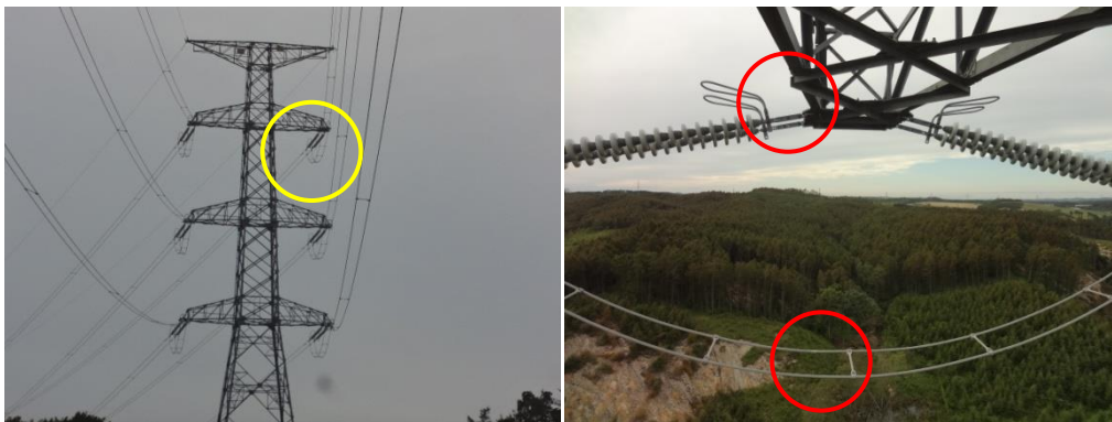
図 2.7 275kV 狩勝幹線の事故箇所
