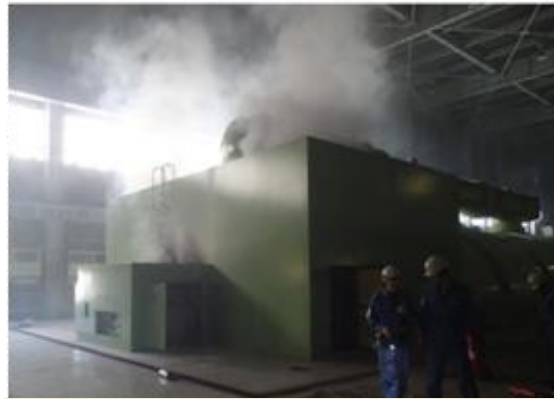
タービン出火状況
