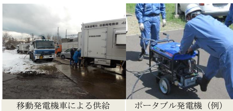
図 3.20 移動発電機車とポータブル発電機
