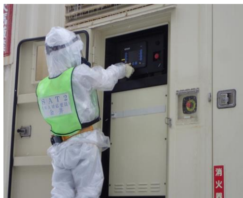
電源車起動訓練
