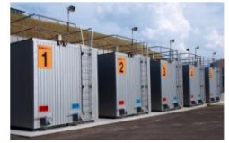
代替屋外給水タンク
