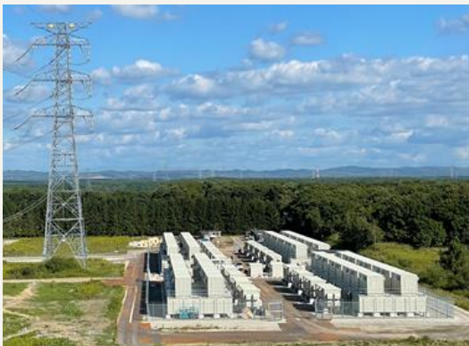
I期蓄電池 外観▶
