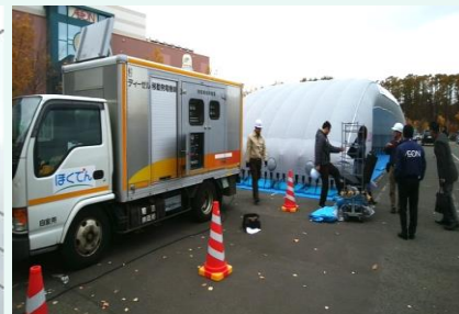
移動発電機車による電力供給
