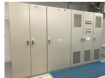
直流電源装置 (整流器・蓄電池収納型)
