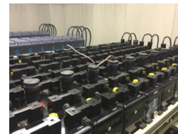
直流電源装置 (蓄電池 据置型)
